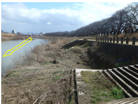
写真-2 土砂堆積と植生繁茂の状況 (平成29年2月24日)
