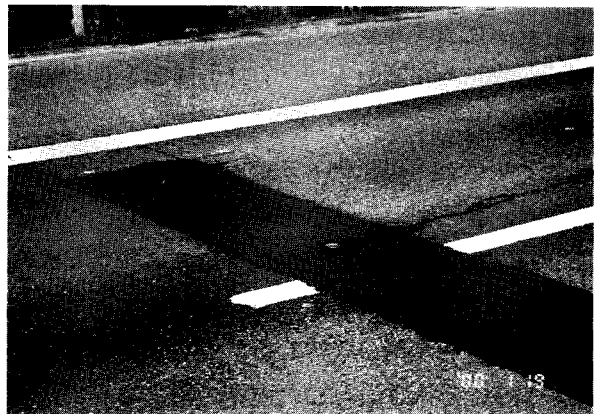
図26. しみだしの様子（2号機、上り車線側）
